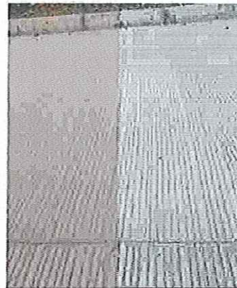
JUNTAS DE DILATACION SELLADAS
