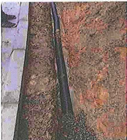
FILTRO FRANCES BORDE DE VIA
