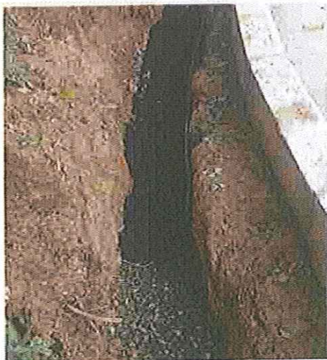
FILTRO FRANCES BORDE DE VIA
