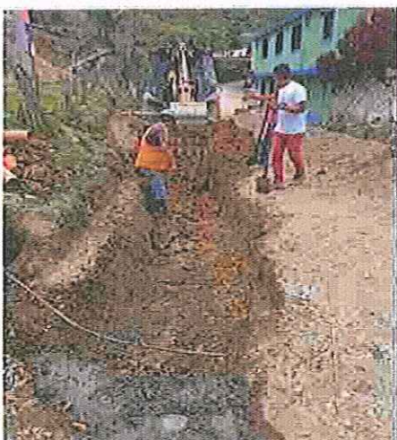
RETIRO DE FALLOS ENCONTRADOS
